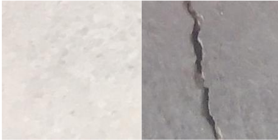
Şekil 27 Çatlak İçermeyen Yüzey Görüntüsü
